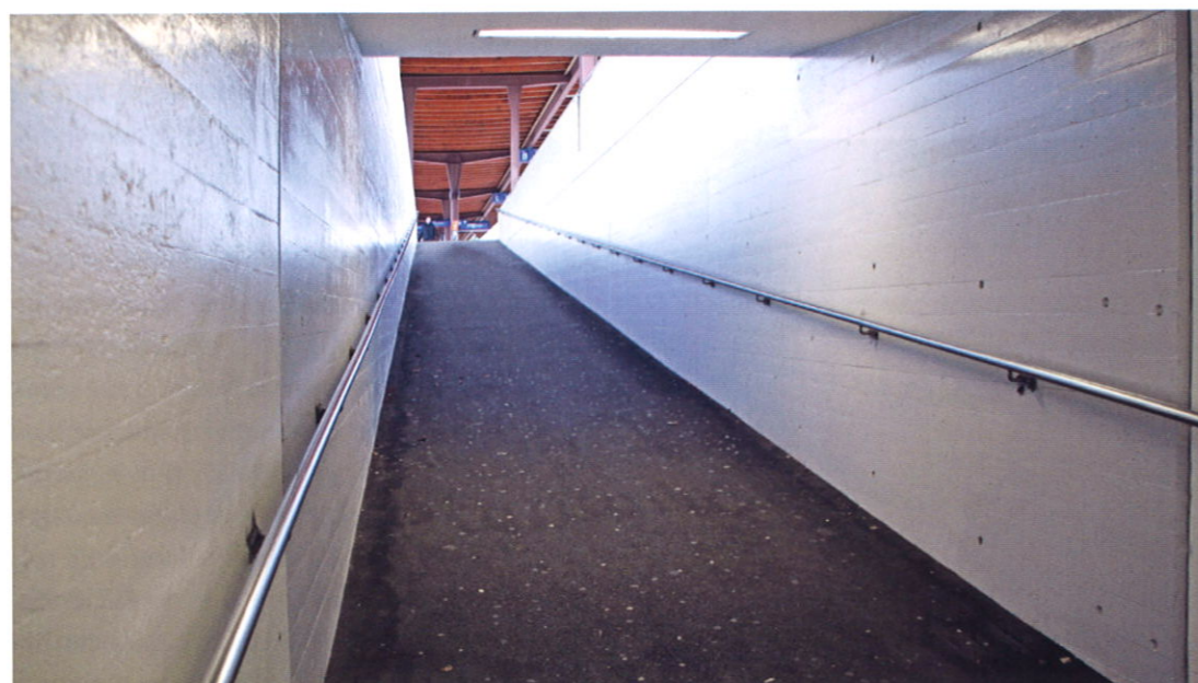
Les résines ou peintures époxy sont également souvent appliquées sur les murs à forte sollicitation.
